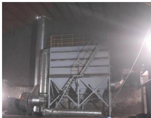
球团膨润土料仓粉尘除尘器
