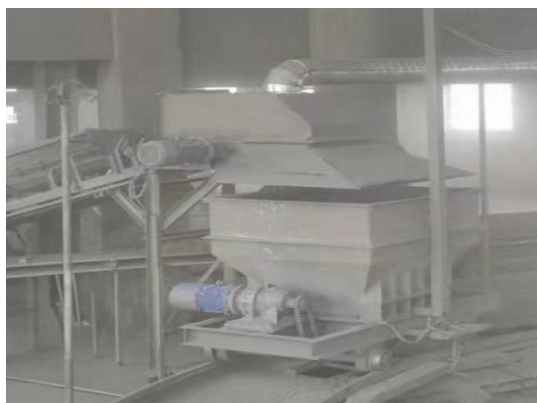
炉顶上料收尘罩（布料小车上方）2个
