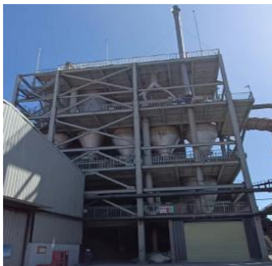
1#煤气净化装置
