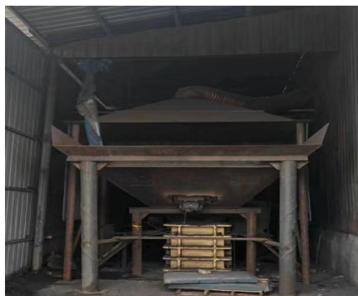
重渣破碎收尘设施
