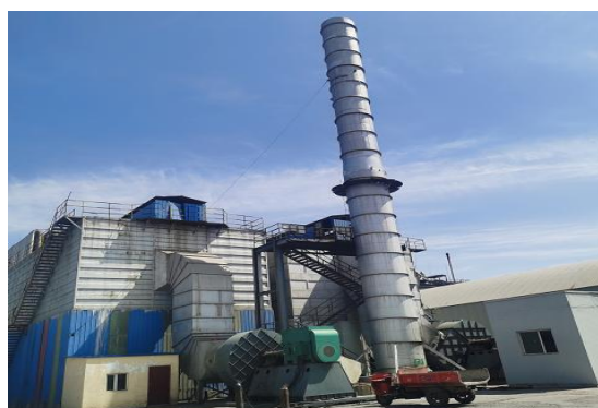
配料、上料、重渣破碎、出铁浇铸除尘及排口
