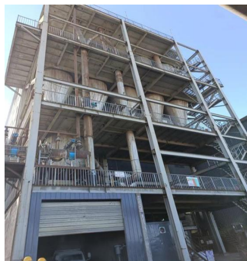
2#煤气净化装置
