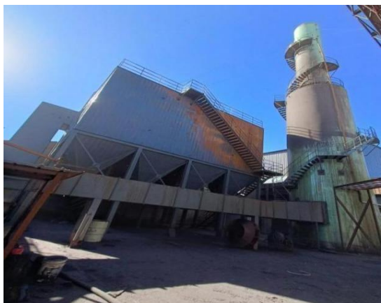
耐高温布袋除尘器+双碱法脱硫装置
